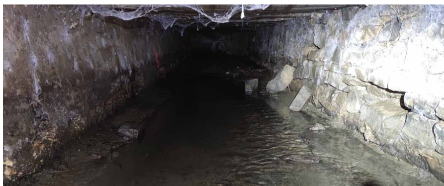
■ Degradace stěn zatrubnění potoka, prověšení stropu a silná hloubková koroze ve výtuzích nosných konstrukcí.
